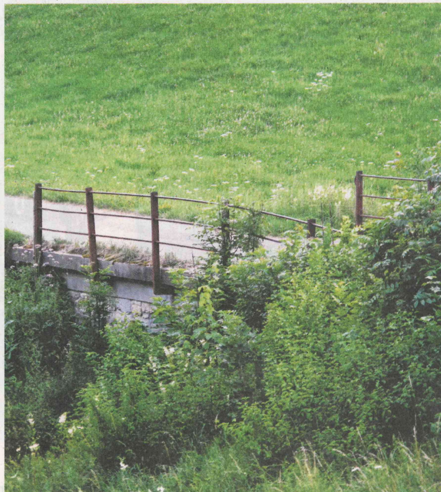
Die marode Bilsteinbrücke hat beim Sanierungsprojekt erste Priorität. Bild Beat Ermel
